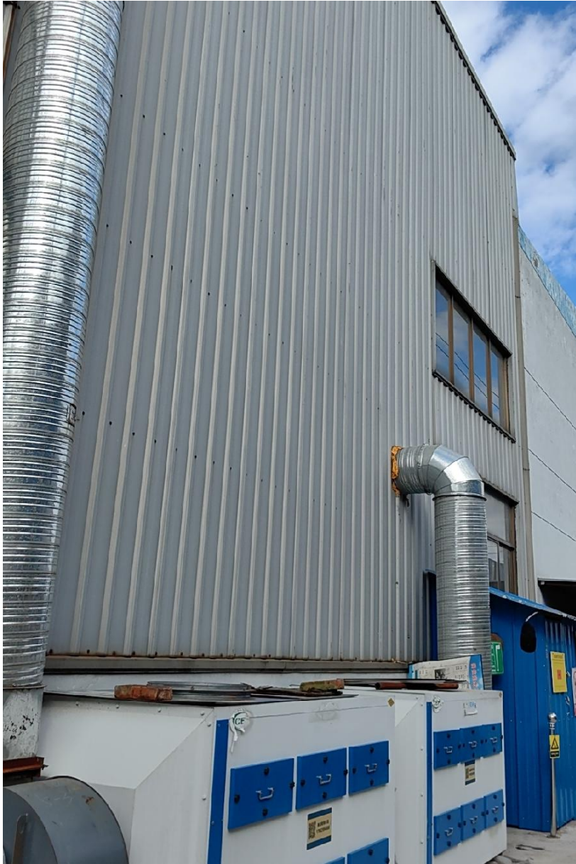
图 3-2 废气处理设施
