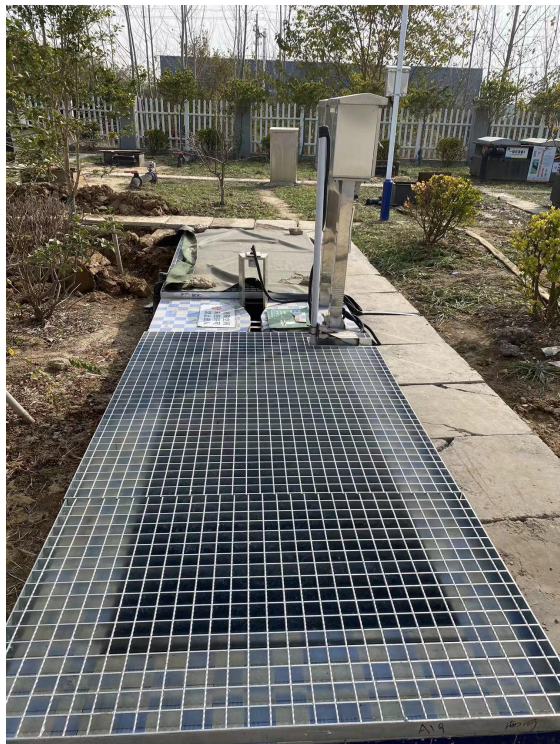
DW001 污水排放口
