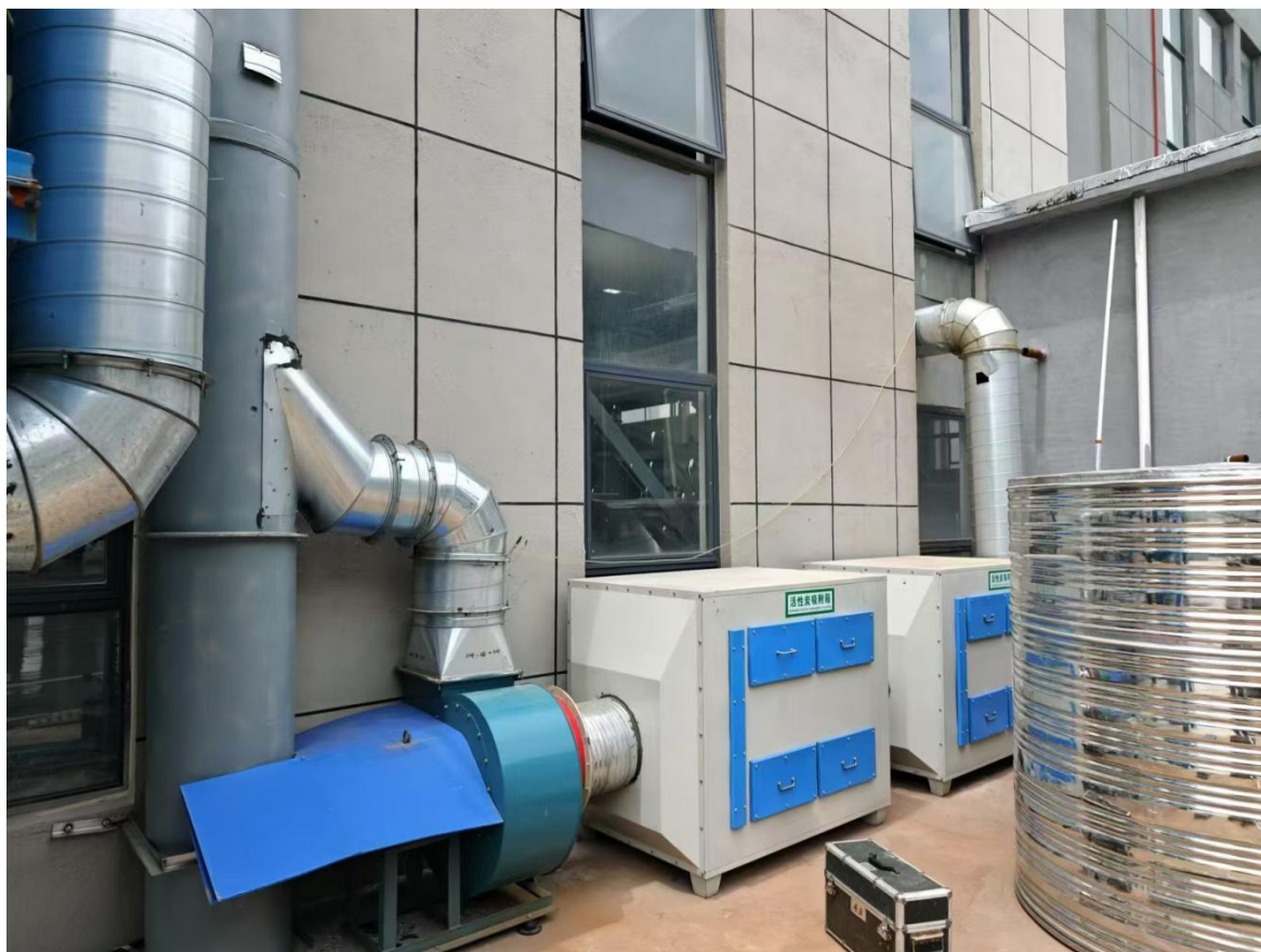
2#排气筒二级活性炭装置
