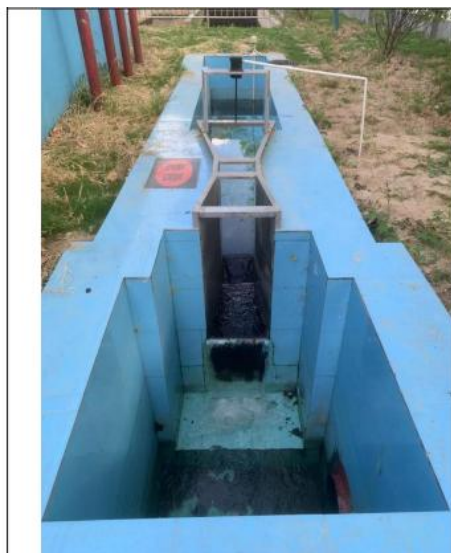
DW001 污水排放口
