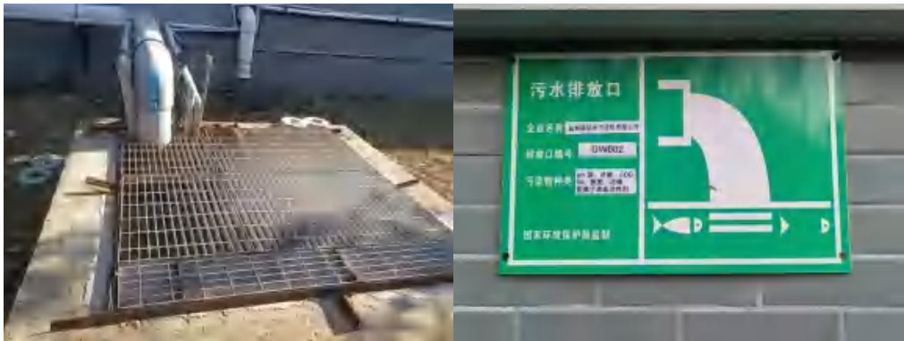
切片废水排放口及标识标牌
