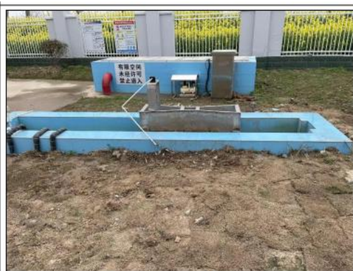
DW001 污水排放口
