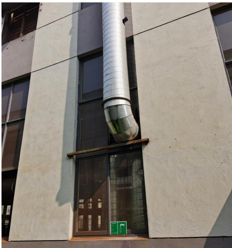
DA001 废气排放口
