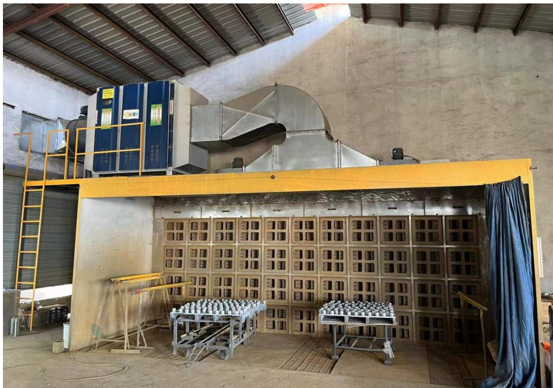
喷漆车间处理设施
