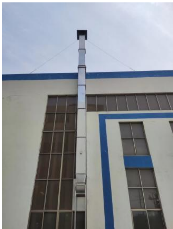
DA001 废气排放口
