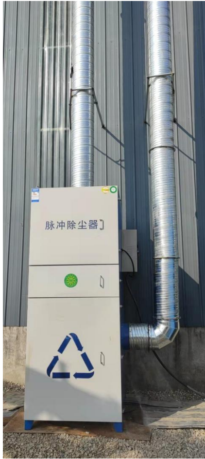
图 3-4 布袋除尘装置
