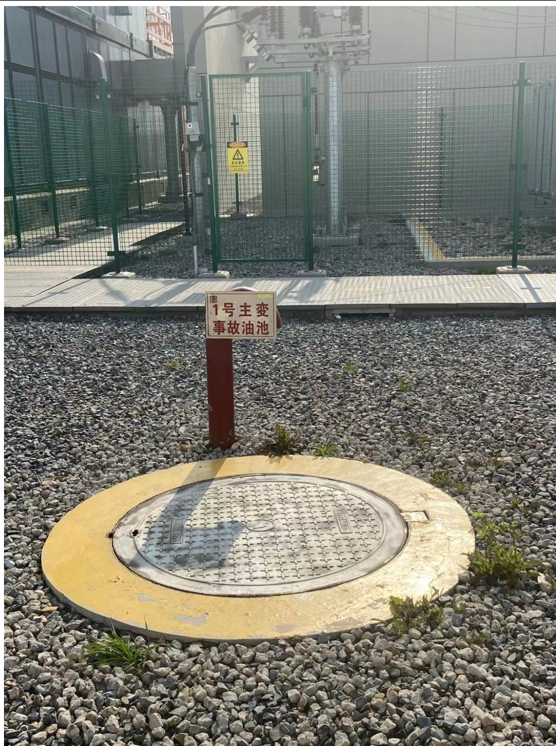
图 2.6 事故油池照片
