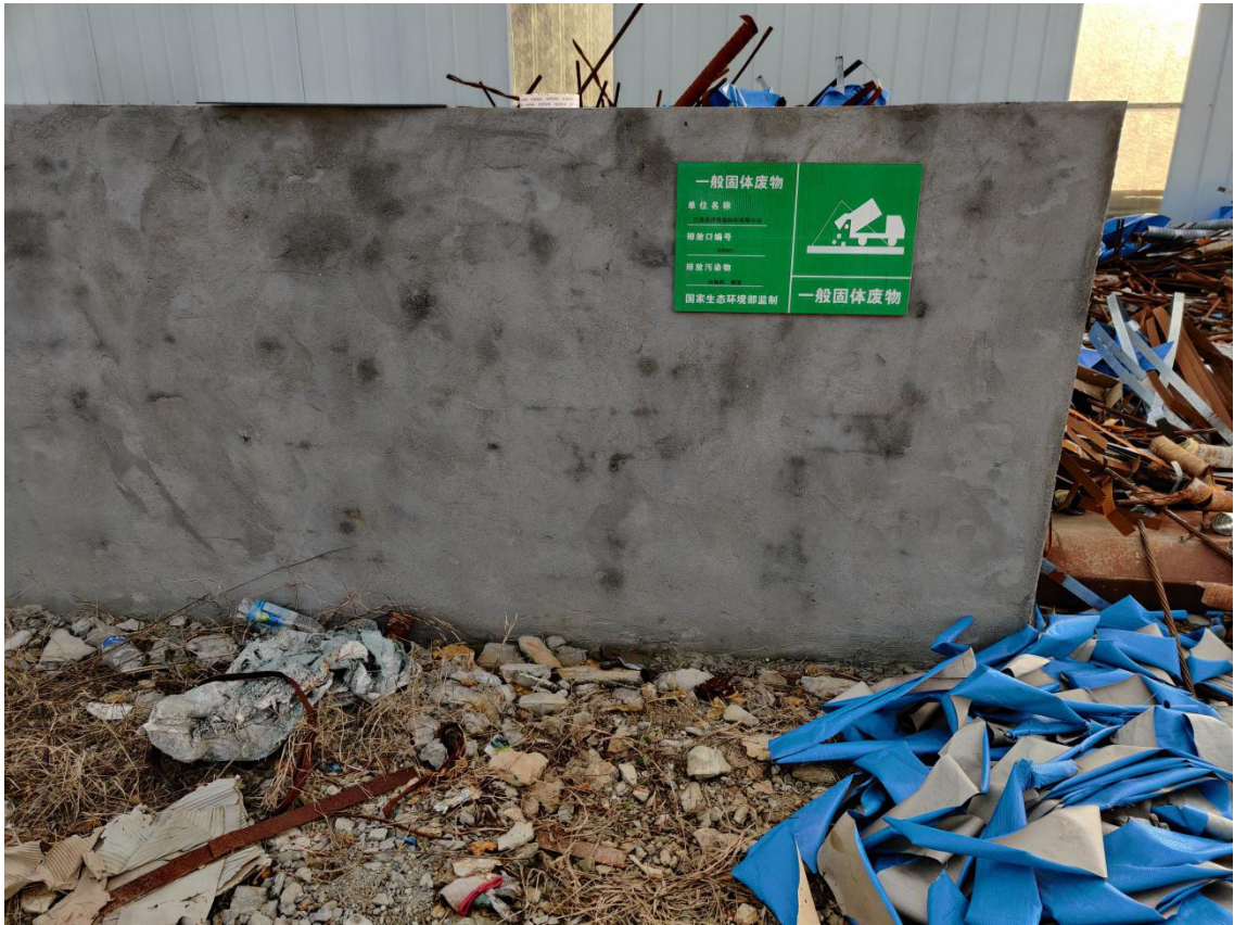
图 3-6 一般固废暂存场所
