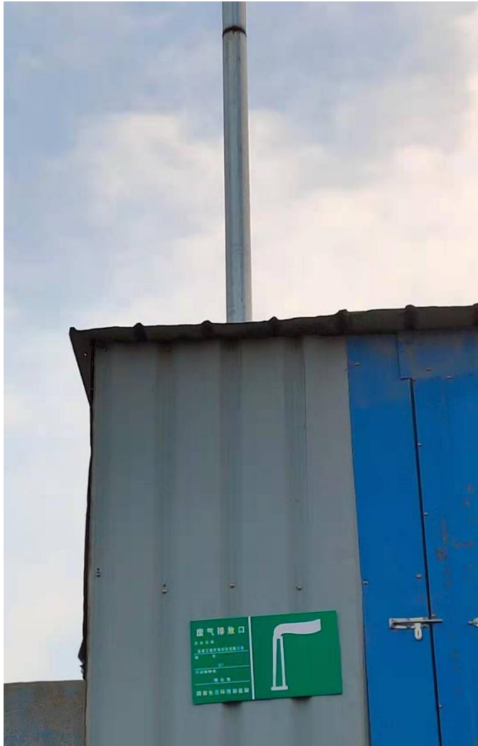
图 3-3 有组织废气排放口
