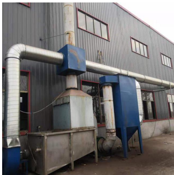
图 3-4 旋风除尘器+布袋除尘器
